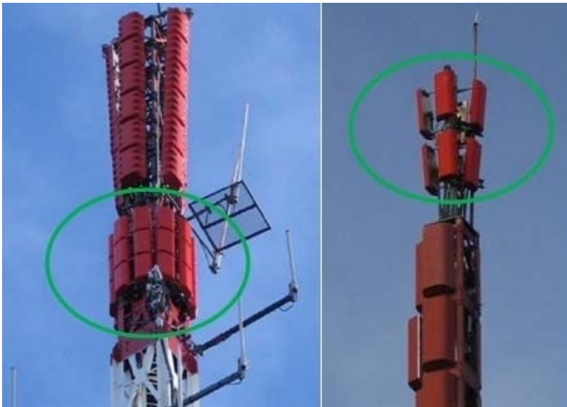
Figura 3.3. Sistemas radiantes de TDT en Oiz: Itelazpi (izq.) y Abertis-Telecom (drcha.)
