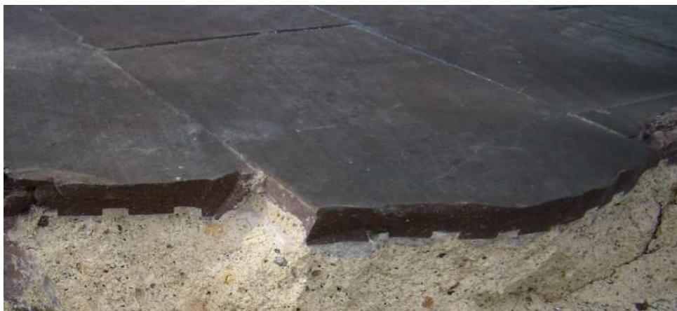
Baldosín catalán, con cuerpo arcilloso marrón oscuro. Suelo de balcón del edificio de 36 viviendas situado en Gipuzkoa, 15 de Zarautz y construido en los primeros años setenta. Fotografía del autor.
