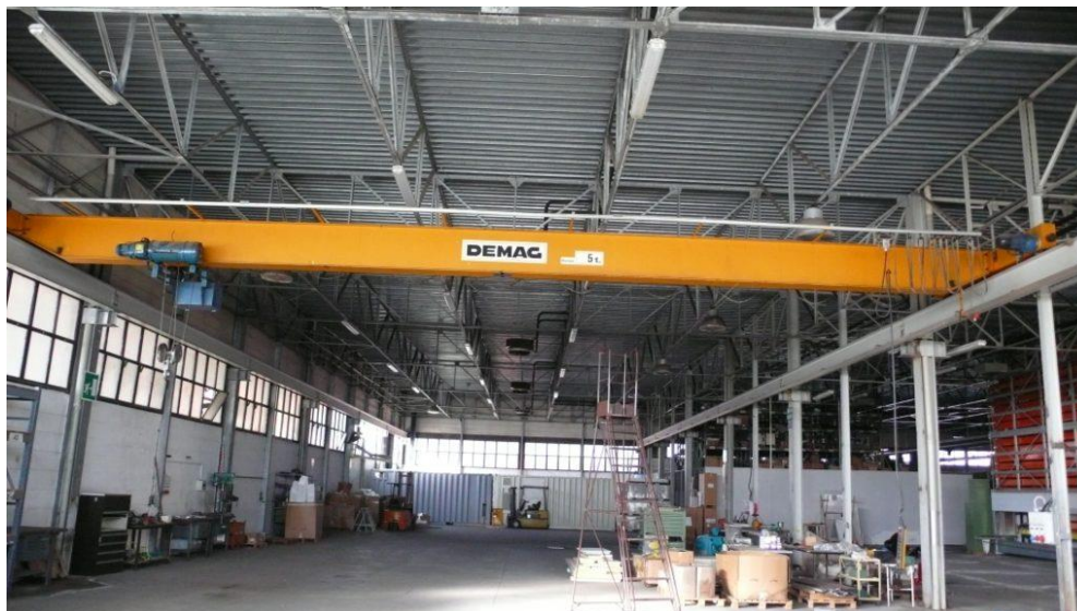
Figura 11. Puente grúa DEMAG.
