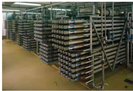
Figura 12. Descripción esquemática del flujo en membranas tubulares (Parte superior). Planta industrial de ultrafiltración perteneciente a Borregaard (Parte inferior).
