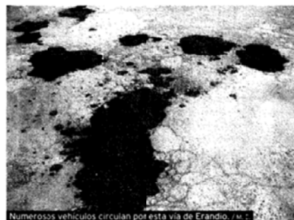
Carretera parcheada en la ikastola Altzaga
