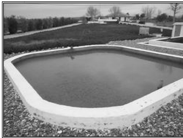
Figura 18. Fotografía de una laguna de depuración.
