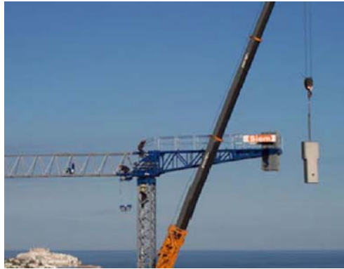
Figura 8. Contrapesos de hormigón de la contrapluma
