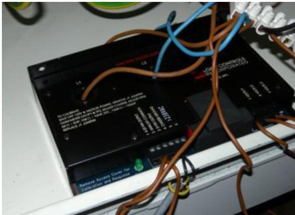
Figura 2.39. Potenciómetro instalado en el cuadro de luces de la máquina.
