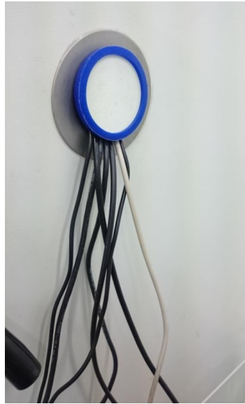
Ilustración 15: Parte exterior del cableado que conecta interior y exterior con el tapón colocado
