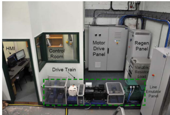
Figura 6.14: Banco de pruebas y sala de control.
