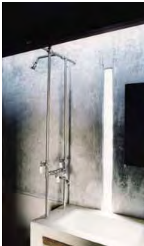
Fontanería expuesta en el baño de la Casa Schindler
