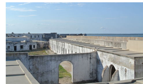
068. Sistemas de recogida de aguas pluviales en cubierta. Forte de São Sebastião, Ilha de Moçambique.
