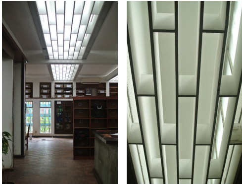
278. Biblioteca Municipal (1969), Quelimane. Sistema de iluminación interior.
