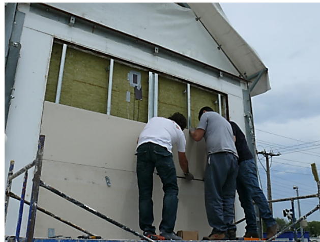
Figura 4.21 – Ejemplo de disposición de las sondas en las superficies que forman la cámara ventilada, imagen izquierda, y detalle de la instalación de los sensores
