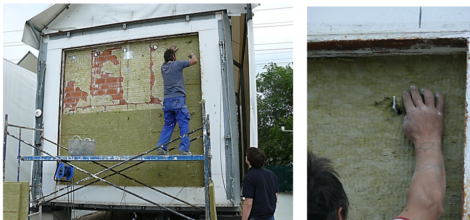
Figura 4.11 – Colocación de la lana de roca y detalle de la penetración de los anclajes puntuales en la capa de aislamiento
