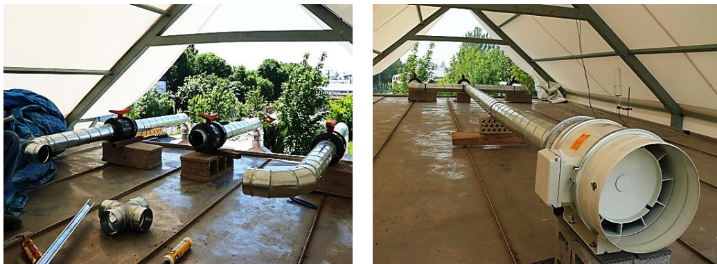
Figura 4.42 – Sistema de extracción forzada de la cámara ventilada
