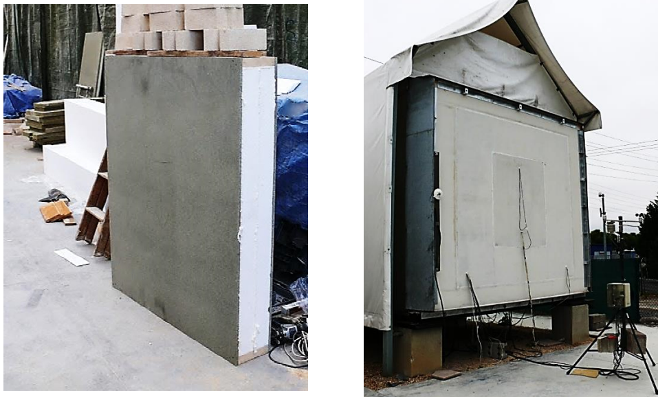
Figura 3.7 – Fabricación pieza zona central del muro opaco y montaje en la celda del primer componente
