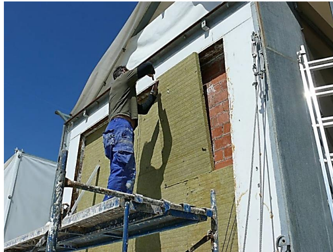
Figura 4.5 – Colocación de la lana de roca sobre la hoja de ladrillo perforado
