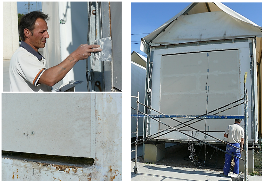
Figura 4.13 – Sellado de juntas de la hoja exterior y detalle de entrada de aire
