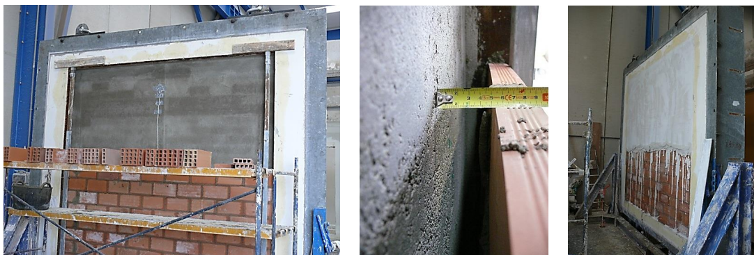
Figura 4.3 – Construcción hoja interior, control del espesor de la cámara de aire y revestimiento final de yeso
