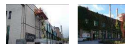
Fig. 22.25: URANGA, E.J., Pabellón Europa de Gasteiz antes de intervención energética , [Fotografía], Gasteiz, 2012.
