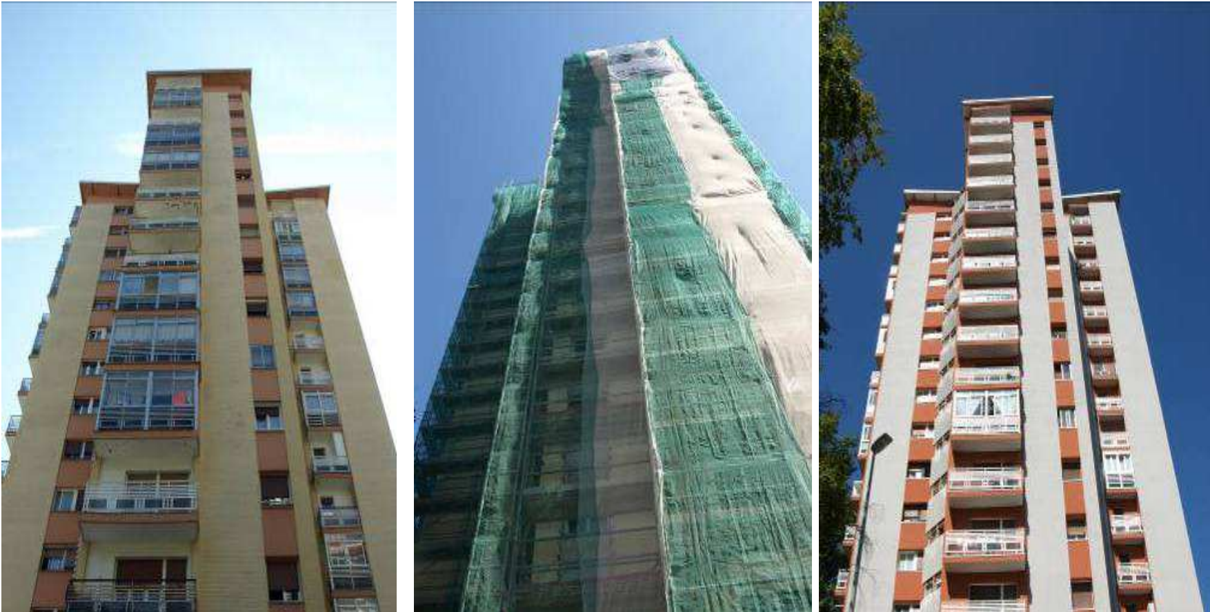
Fig. 22.92, 22.93 y 22.94: Fachadas de edificios residenciales antes, durante el proceso de obras y después de la finalización de las mismas. Bidebieta, Donostia.
