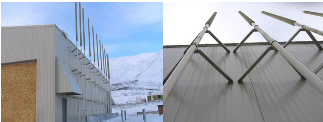
Figura 1.17. Termosifones utilizados como soportes en construcciones de Alaska.
