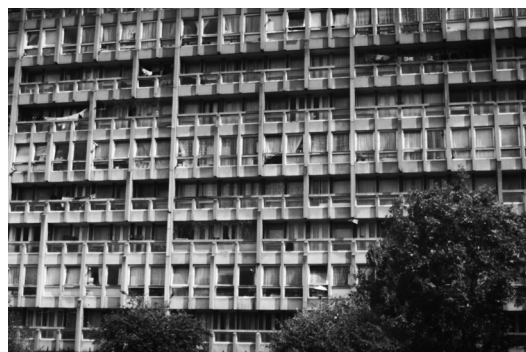
Fig.42. Abandono y deterioro, que desde 2008 está propuesto para su demolición. 2015.
