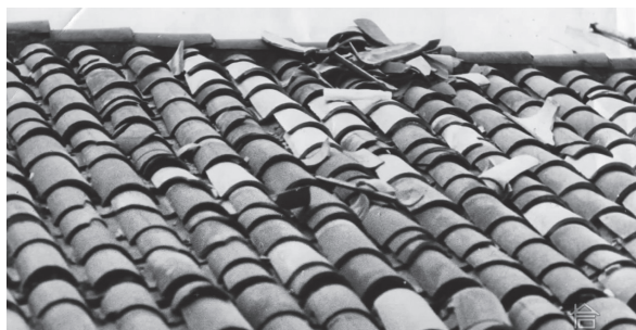
Fig. 119. Rotura de tejas de cubierta.
