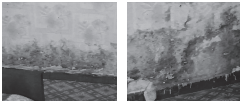
Fig.112-113. Humedades en el interior de las viviendas.
