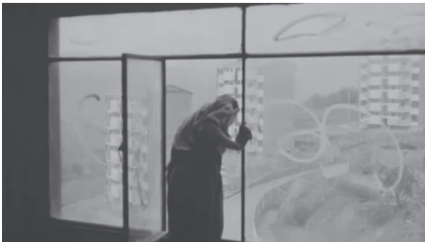
Fig. 121. Carpintería exterior metálica con vidrio simple.
