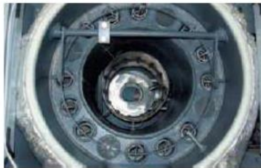
Figura 21. Intercambiador de calor de caldera de biomasa. (Fuente [16])
