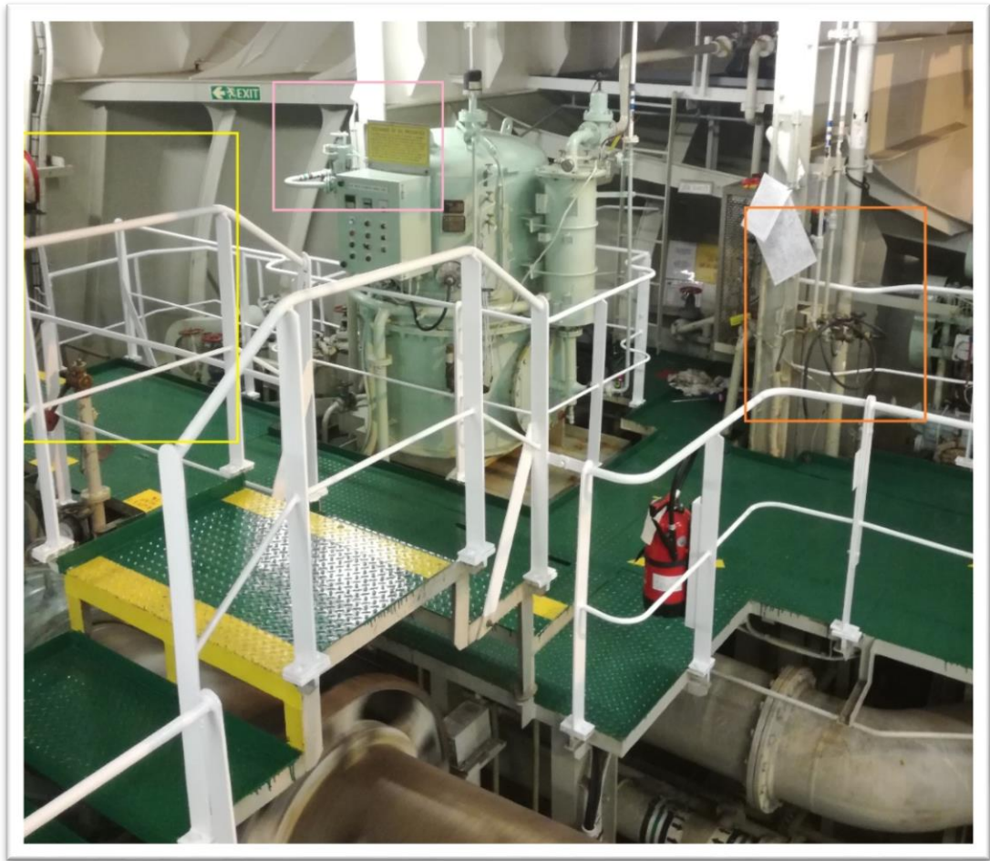
Ilustración 23 Localización de toma de aire y agua para limpieza
