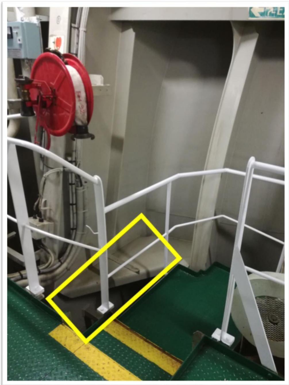
Ilustración 22 Localización provisional unidad de control de aire
