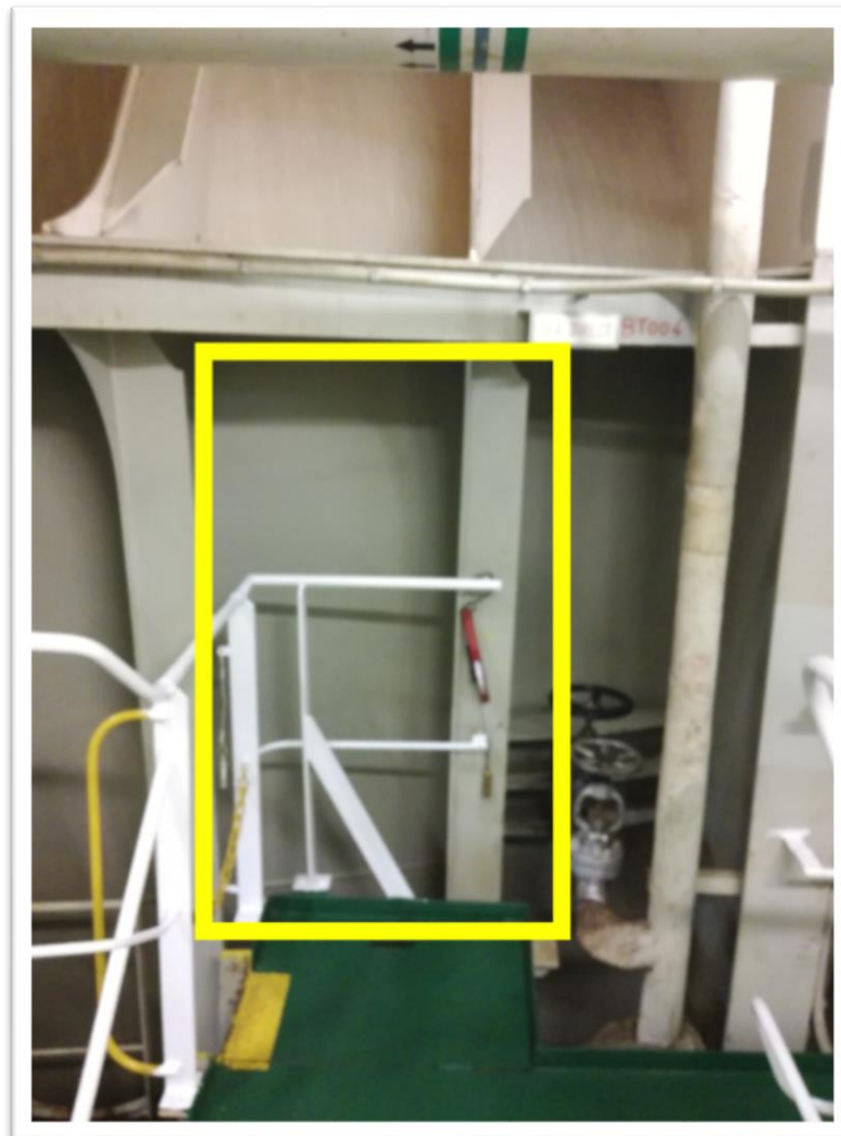
Ilustración 26 Localización provisional panel de operación de las bombas
