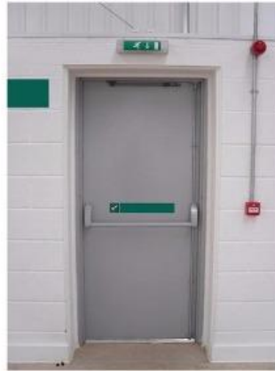
Figura 32. Puerta exterior con barra antipánico
