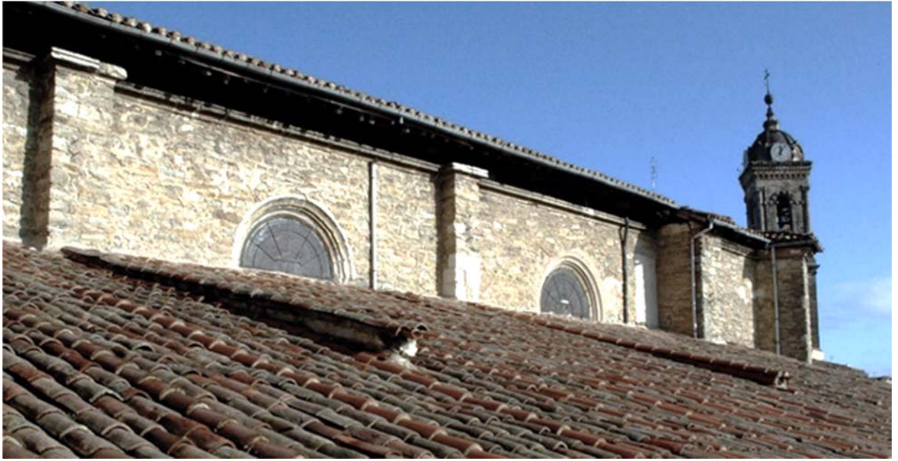
Fig. 3.- Arriba, imagen inicial de la cubierta sur, donde los arbotantes escondidos asoman levemente y los óculos de la nave central quedan parcialmente ocultos. Abajo, los mismos elementos ignorados en las entrecubiertas.
