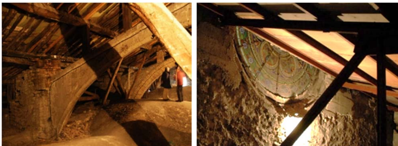
Fotografías de las entrecubiertas de San Miguel antes de las obras de reforma
