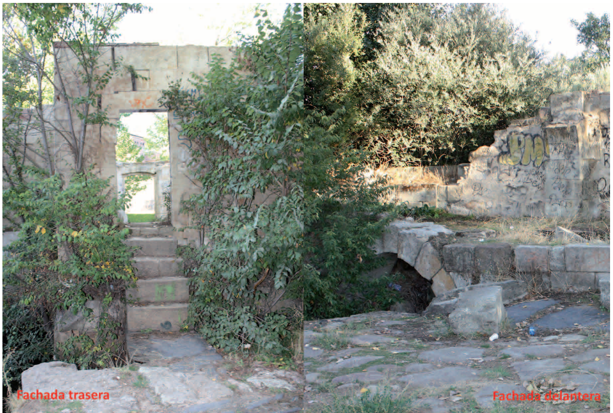
Figura 4. Estado actual del molino de San Jerónimo. A la derecha se observa uno de los arcos colmatado de grandes bloques pétreos, residuos y basura (fotografías de C. Hernando).
