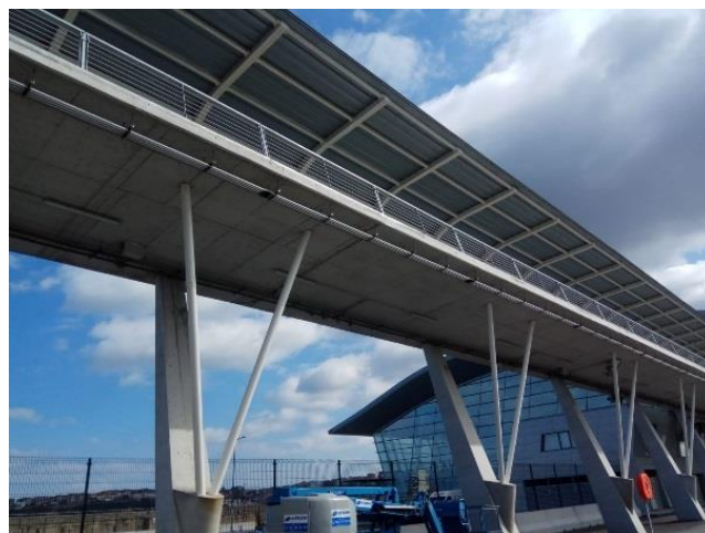
Figura 29 Focos bajo pasarela de hormigón (2)
