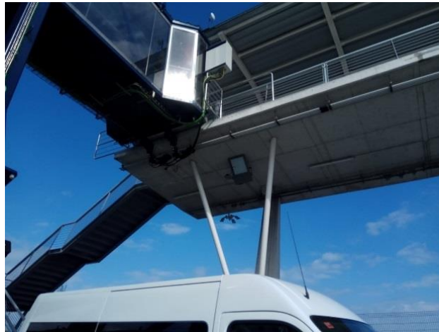
Figura 28 Focos bajo pasarela de hormigón (1)
