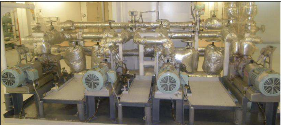
Figura 1.17: Las cuatro bombas de circulación. (Ilustración propia)
