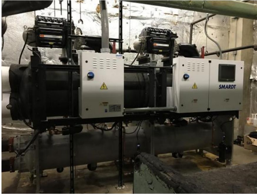
Ilustración 3. Enfriadora Turbocool 850 kW.
