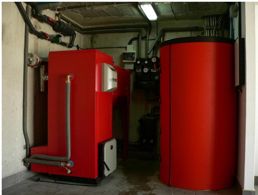
Ilustración 4. Caldera de Pellet para el Back-up.
