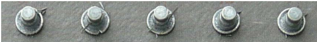
Figura 4.7.2. Remaches incorrectamente instalados previos: presentan anillos y picaduras.
