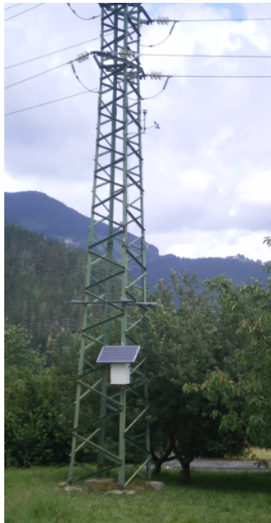
Figura 1 Sensores instalados en Elgoibar
