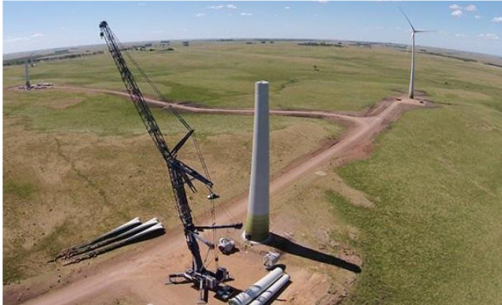
Figura 27. Grúa sobre la plataforma de montaje junto a los distintos tramos de torre.
