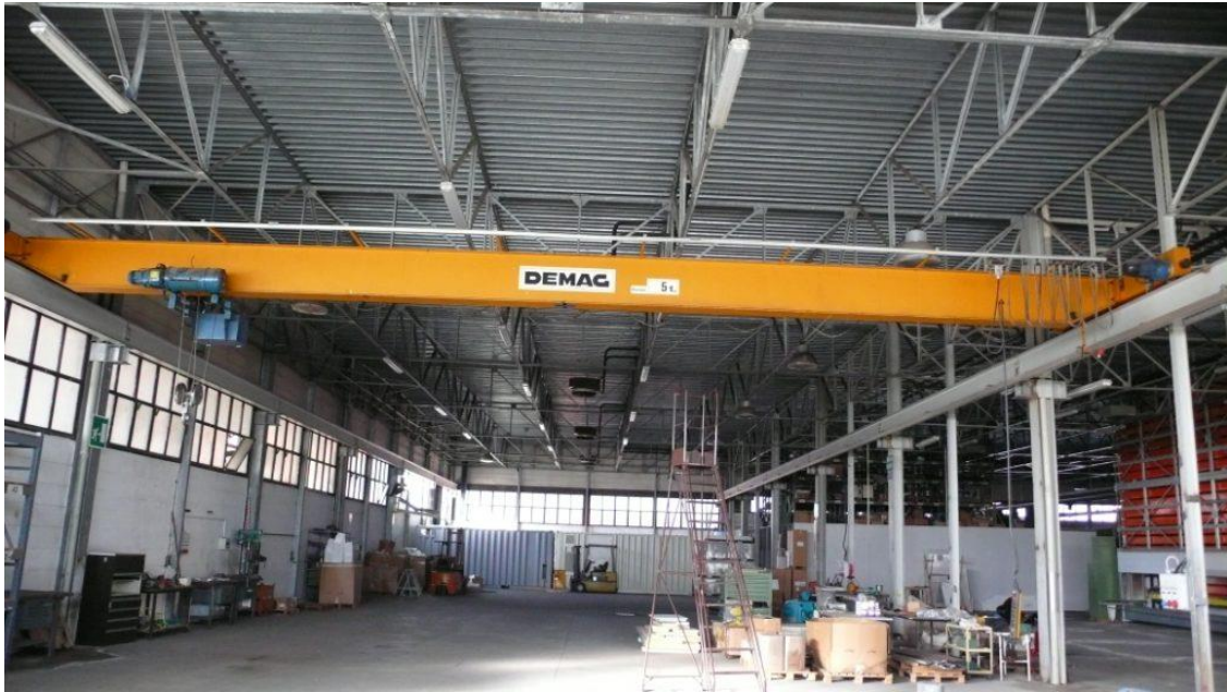
Figura 7: Puente grúa DEMAG
