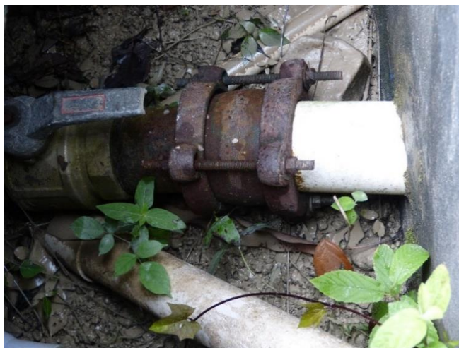
Ilustración 29: Válvula de compuerta encargada de abrir el paso de agua a la red de suministro desde el tanque de almacenamiento, Fuente: NUEVI
