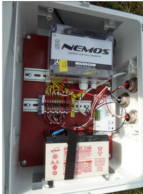
Ilustración 15. Armario de centralización de medidas.
