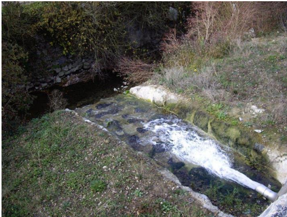
Figura 3: Vertido de la EDAR de Orduña al caudal del río.
