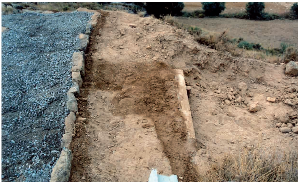
FIGURA 3. Conducción de zanjas perimetrales de protección en torno a la zona excavada.
