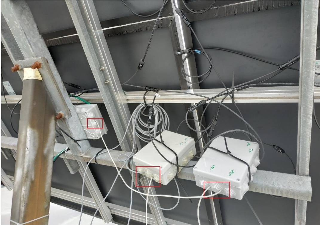
Figura 11. Sistema montado, señalizando los cables de RS485
