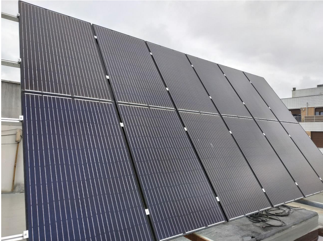
Figura 10. Paneles solares instalados en el tejado de la escuela
