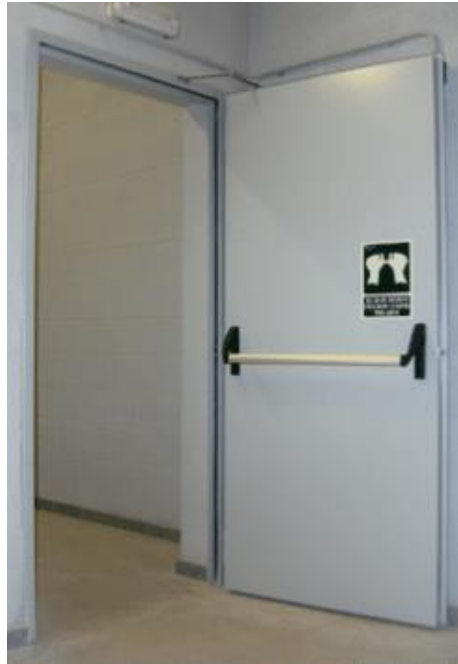
Figura 15. Puerta cortafuegos tipo del proyecto
