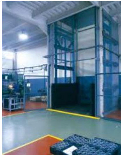
Figura 12. Plataforma elevadora del proyecto. Fuente Enier
