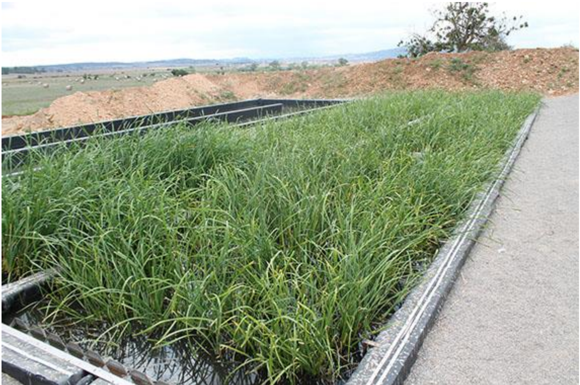
Ilustración 31. Ejemplo de humedal de flujo subsuperficial ya construido
