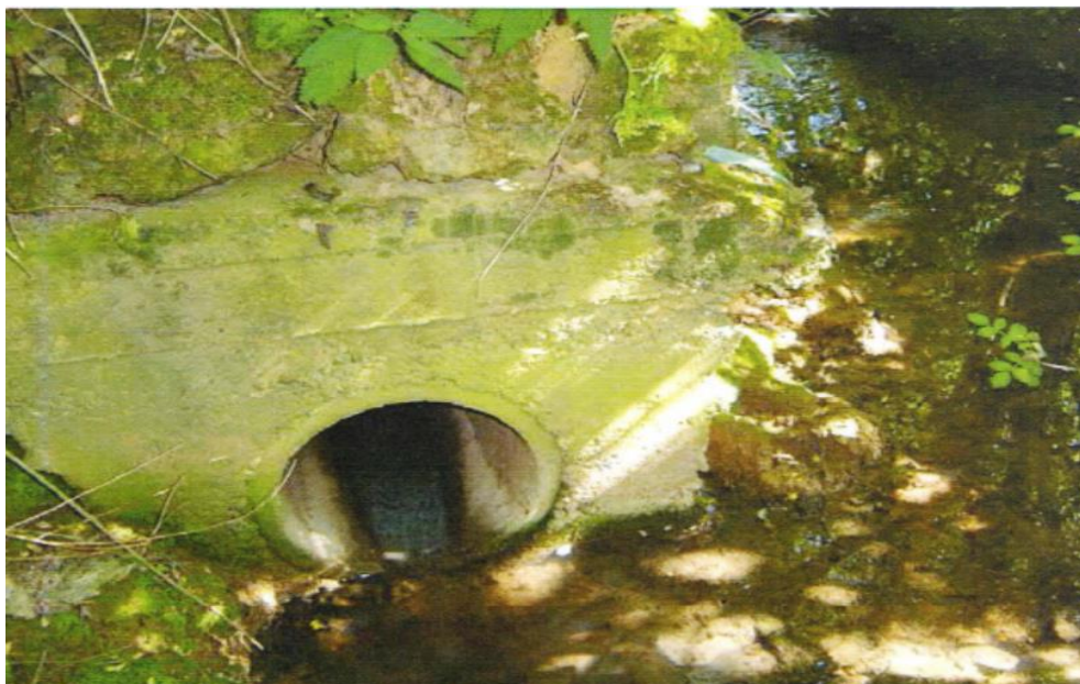
Ilustración 25. Vertido de la actual fosa séptica en el río
