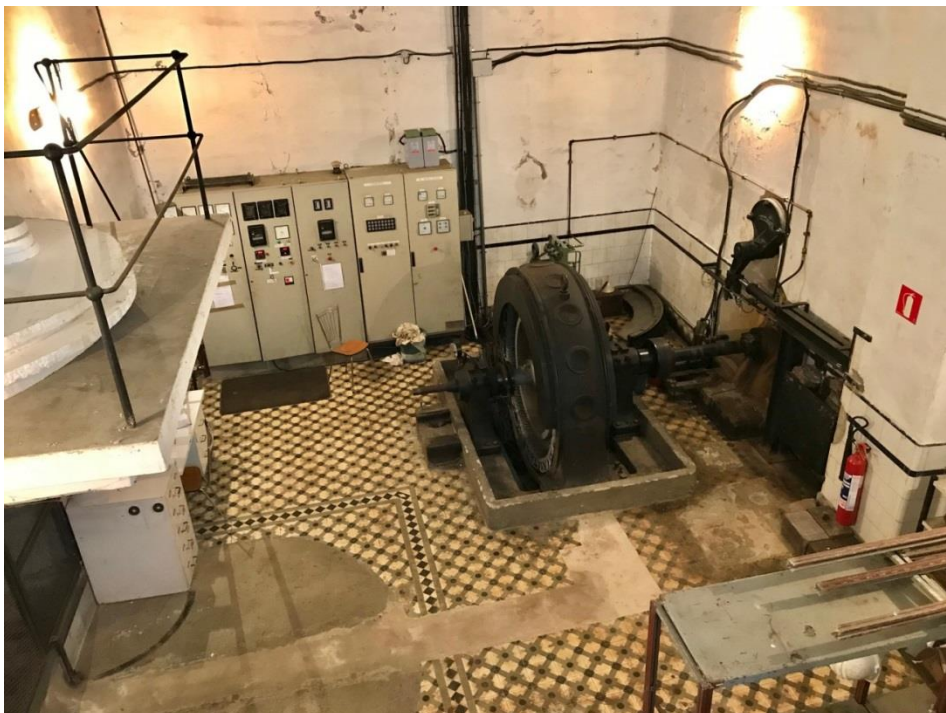
FIGURA 5: Fotografía de la sala de control de la central de Fagollaga
