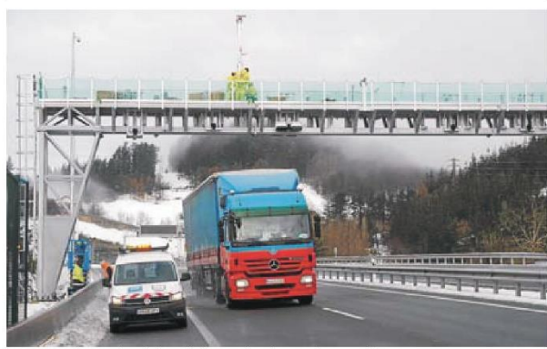
Operarios trabajan sobre el dintel del arco colocado en Deskarga, en la GI-632. :: FÉLIX MORQUECHO
