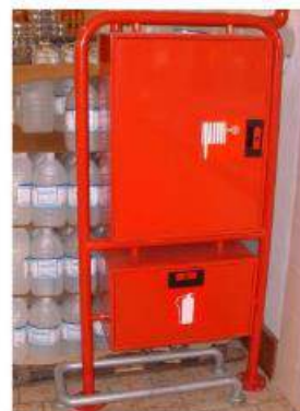
BIE con arcada y extintor
