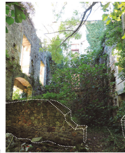
muro parcialmente derruido, en la propuesta este muro se consolidará e integrará dentro de la misma sala de exposición (sala 2)
