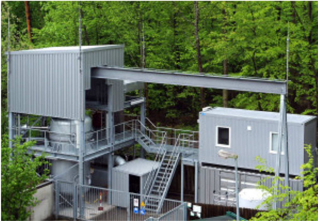
Ilustración 57. Unidad experimental de almacenamiento térmico Julich Solar Tower [SOLAR PACES]
