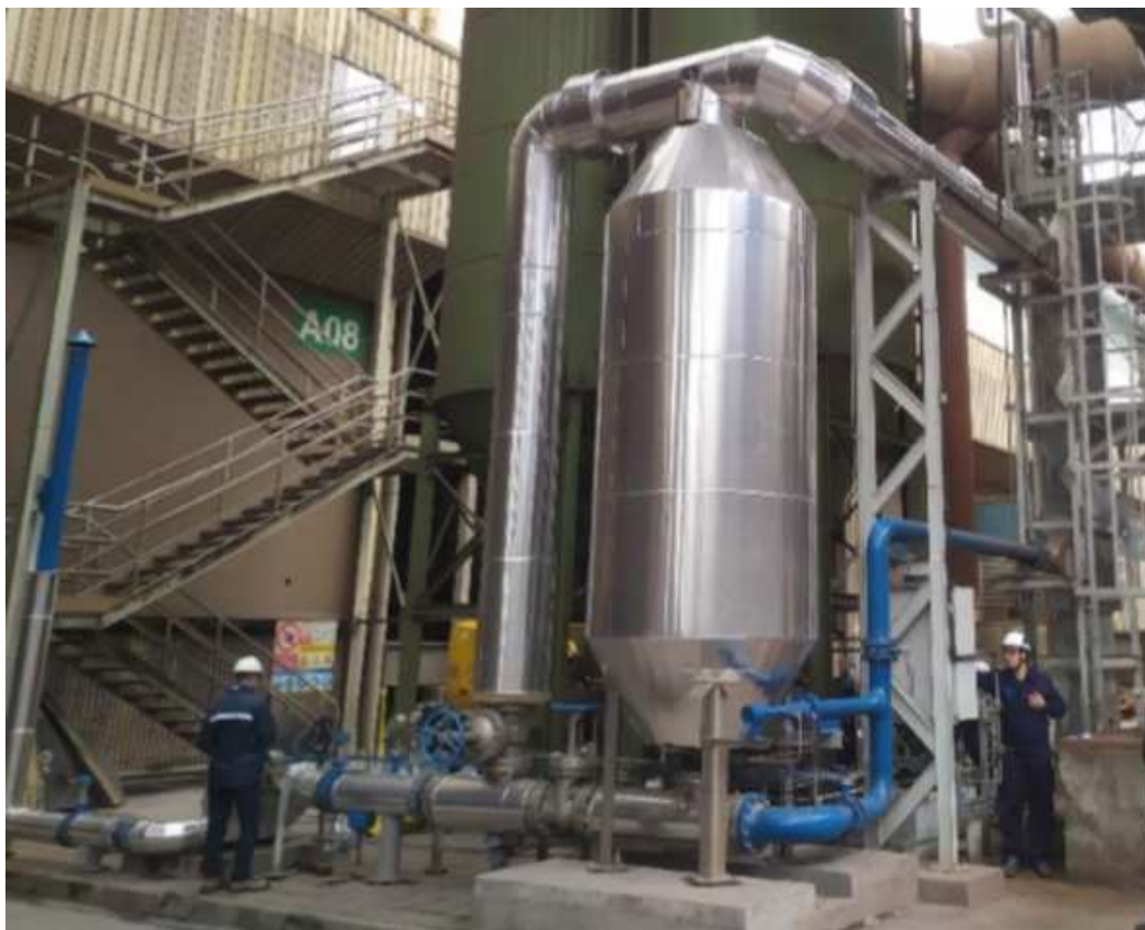
Ilustración 51. Tanque de lecho fijo compacto instalado en ArcelorMittal [52]
