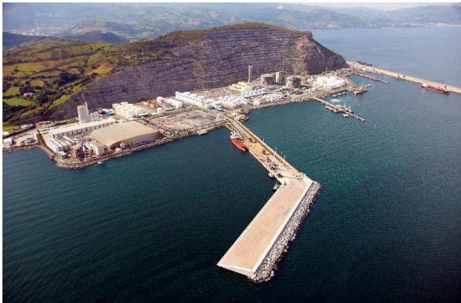
Ilustración 39. Obra de prolongación del dique de Punta Sollana en el Puerto de Bilbao [APB]
