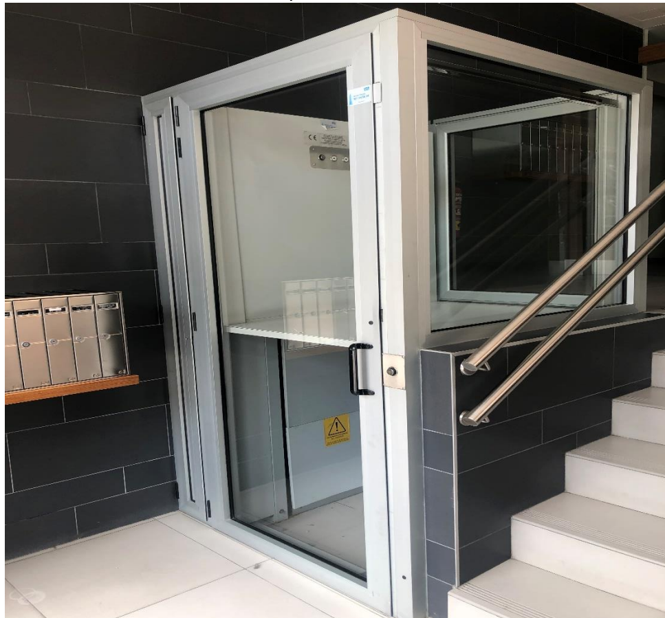
Ilustración 8. Elevador de poco recorrido instalado.
