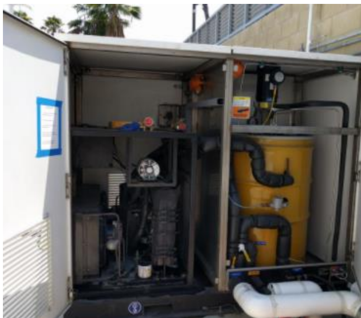
Ilustración 57 Enfriadora de hidrogeno. [Quantum Technologies 70 Mpa Hydrogen chiller. Modified BV Thermal Systems unit. 2019]
