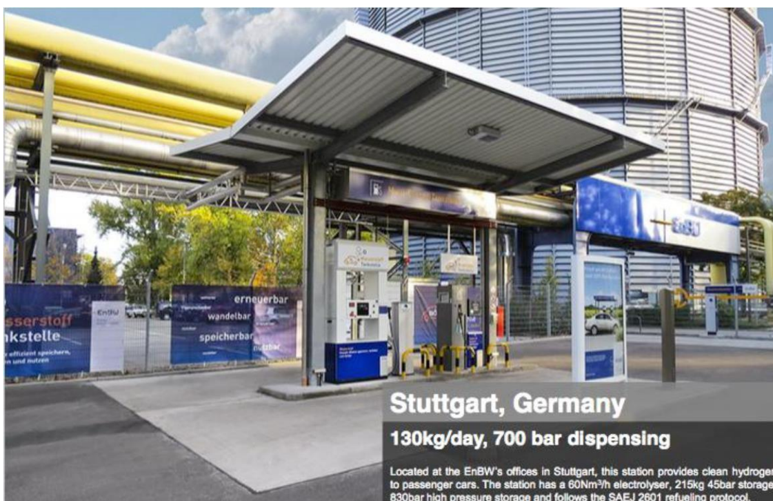
Ilustración 33 Hidrogenera desarrollada por Linde en Stuttgart. [Fuente: Hydrogenics “Hydrogenics selected fueling stations”. 2019]
