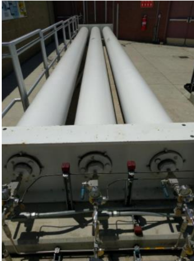
Ilustración 54 Tanques de almacenamiento a baja presión. [Faber Corporation, Italy. 2019]
