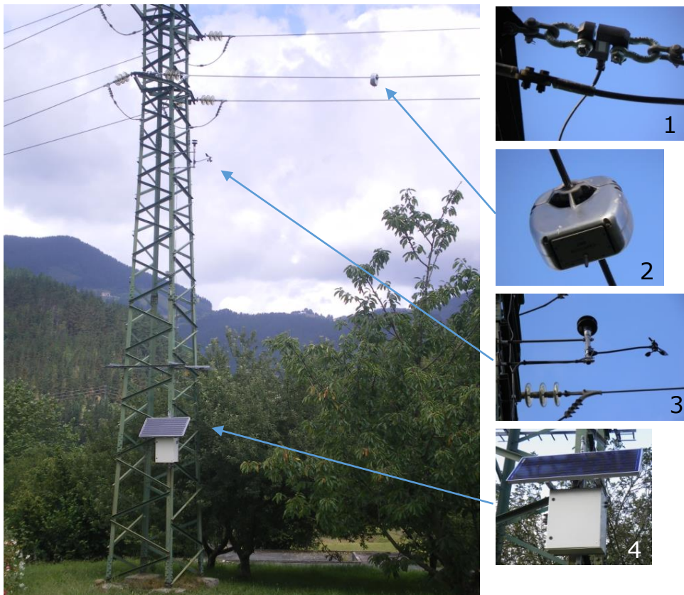
Figura 5. Instalación piloto: 1) célula de carga, 2) sensor de corriente y temperatura superficial del conductor, 3) anemómetros, 4) sensores de temperatura ambiente y de radiación solar.
