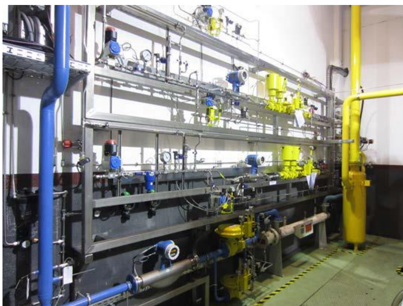
Figura 55. Detalle de las rampas de suministro de gas (amarillo) y aire (azul).
