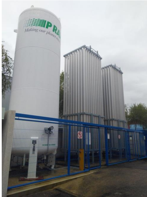
Figura 53. Instalación de suministro de CO 2 .
