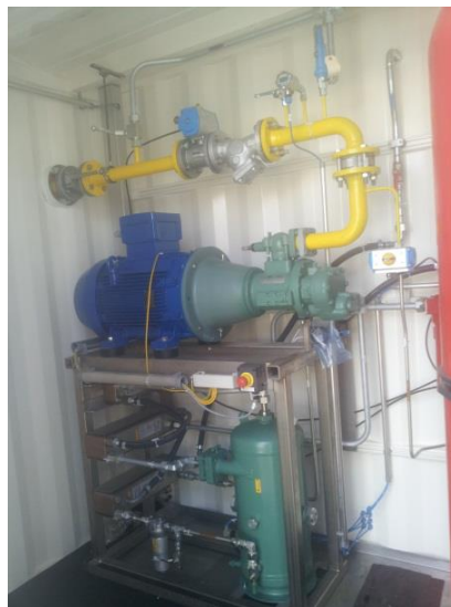
Figura 52. Compresor de gas natural.
