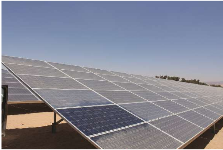
Figura 2.15. Suciedad en módulos FV ubicados en región desértica. La figura muestra uno de los módulos limpios, utilizado como referencia para determinar las pérdidas en el resto de módulos, en los que existe un grado de suciedad debido a la deposición de arena. Extraído de Ferretti et al. [83].
