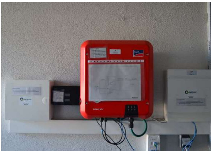
Figura 4.3. Inversor SMA Sunny Boy 3.0, SMA Sunny Home Manager, voltímetro y amperímetro.
