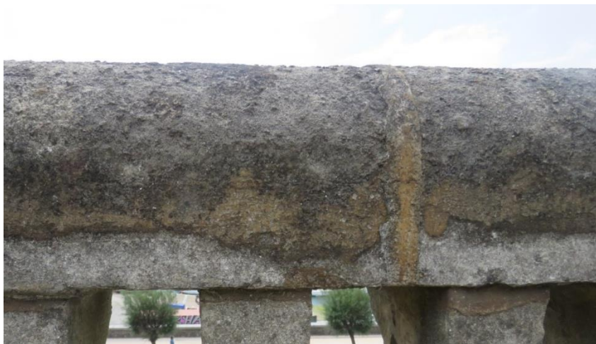
Figura 55. Fractura con desplazamiento en la base de la balastrada, alveolización, costra negra y alteración cromática.
