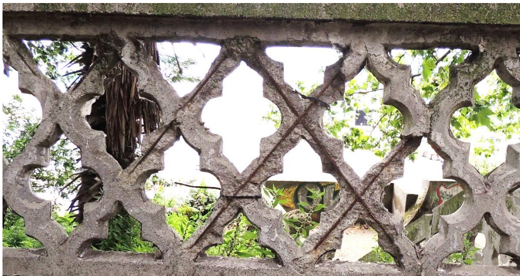
Figura 44. Daños de nivel III. Balastrada junto a la escuela de aprendices (Sestao). 2019.
