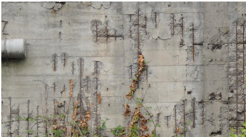
Figura 35. Muro de hormigón armado muy deteriorado por una mala ubicación de la armadura (Erandio). 2018.
