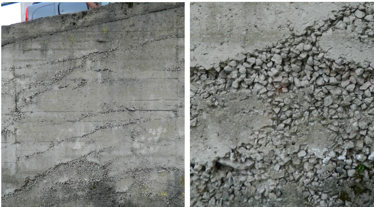
Figura 34. Marcas características de un vibrado insuficiente y detalle de una coquera o nido. Muro de contención en la C\Tres de Noviembre – Santander. 2019.
