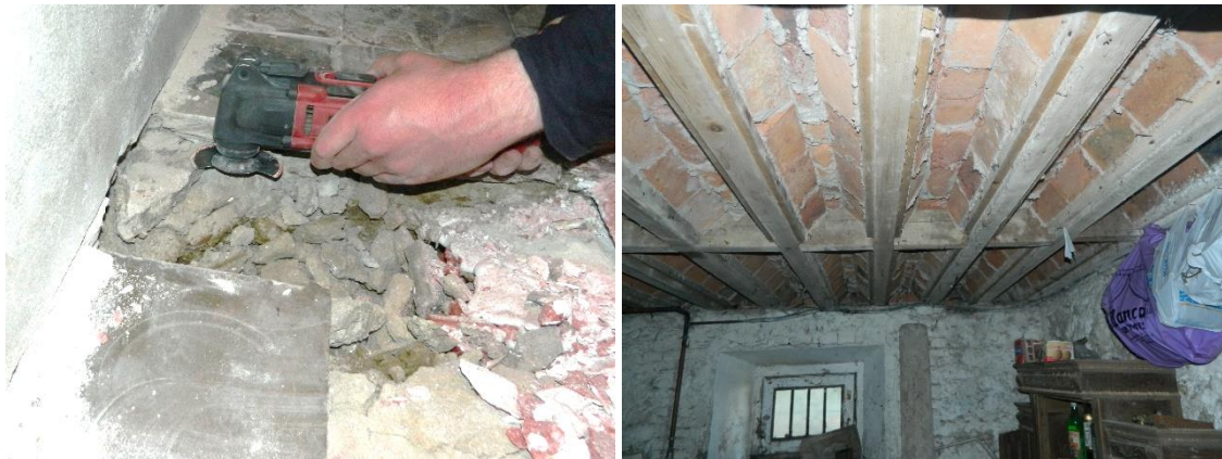
Figura 103. Zona de entrada durante las pruebas de arrancado, en las que se puede ver la falta de apoyo del propio suelo (izq.) y parte inferior de la estructura que soporta el comedor (dcha.). 2021.
