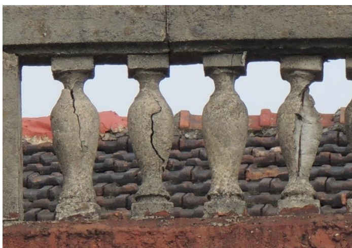
Figura 43. Daños por corrosión de la armadura nivel II. Fachada del palacio Munoa (Barakaldo). 2018.
