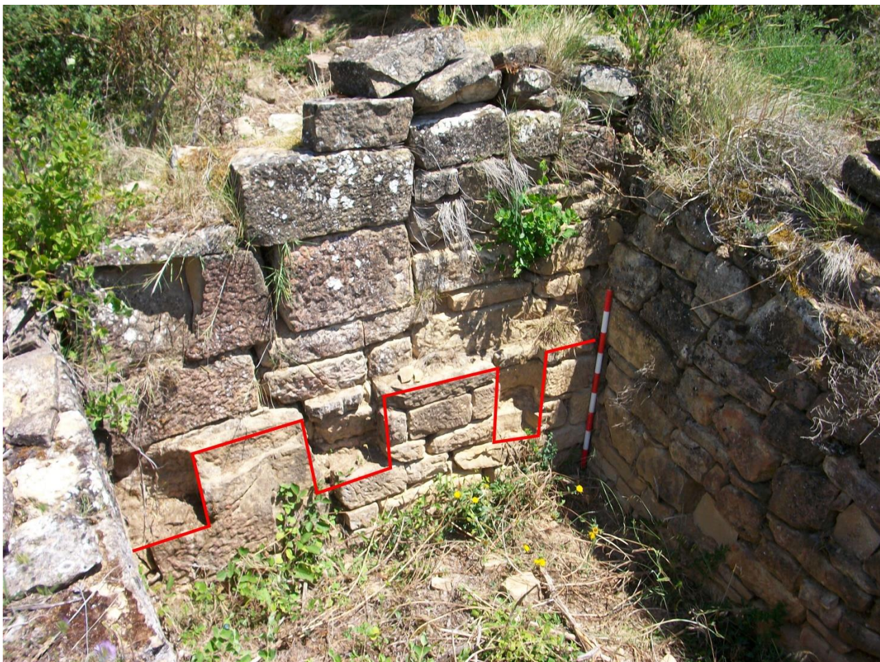
Figura 109. Localización de los tres mechinales descritos en la cara interna del muro norte. Se aprecian en esta cara los dos tipos constructivos citados. El original en la base y la posterior en la parte superior del muro
