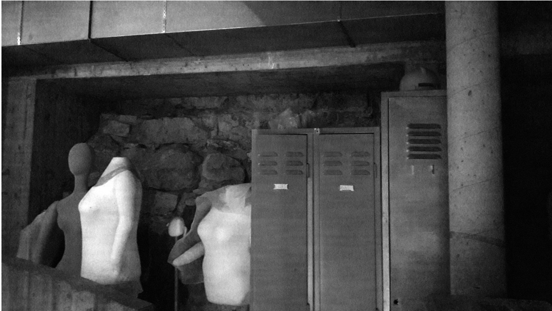
Figs.225: Imagen del sistema de ventilación que se tuvo que implementar para acondicionar las oficinas de la planta sótano. Primavera de 2016.
