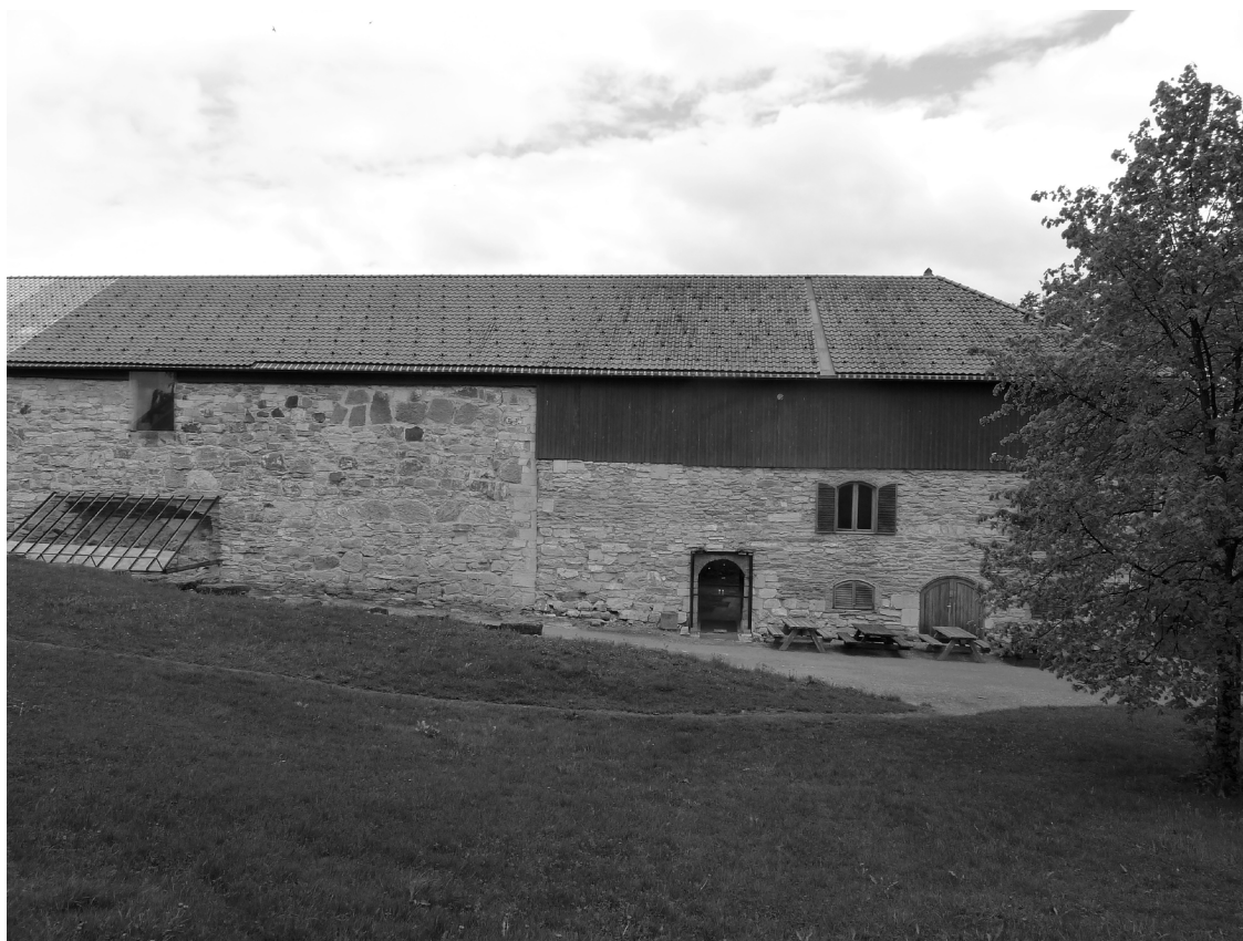
Fig.8: Parte del alzado oeste, se aprecia el corte que existe entre el muro antiguo de la fortaleza del obispo (a la izquierda) y el granero del siglo XVIII (a la derecha). Primavera de 2016.
