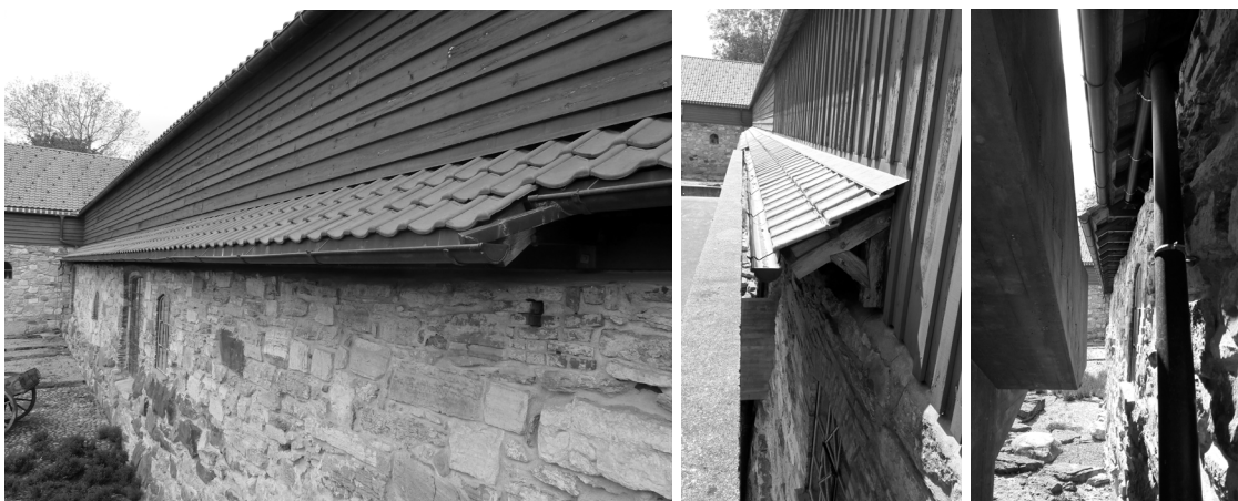
Figs.207, 208 y 209: Imágenes de la tejavana colocada posteriormente para la protección de la cabeza del muro medieval. Se aprecia también el sistema de recogida de pluviales oculto que se tuvo que implementar para recoger las aguas de ese pequeño faldón. Primavera de 2016.
