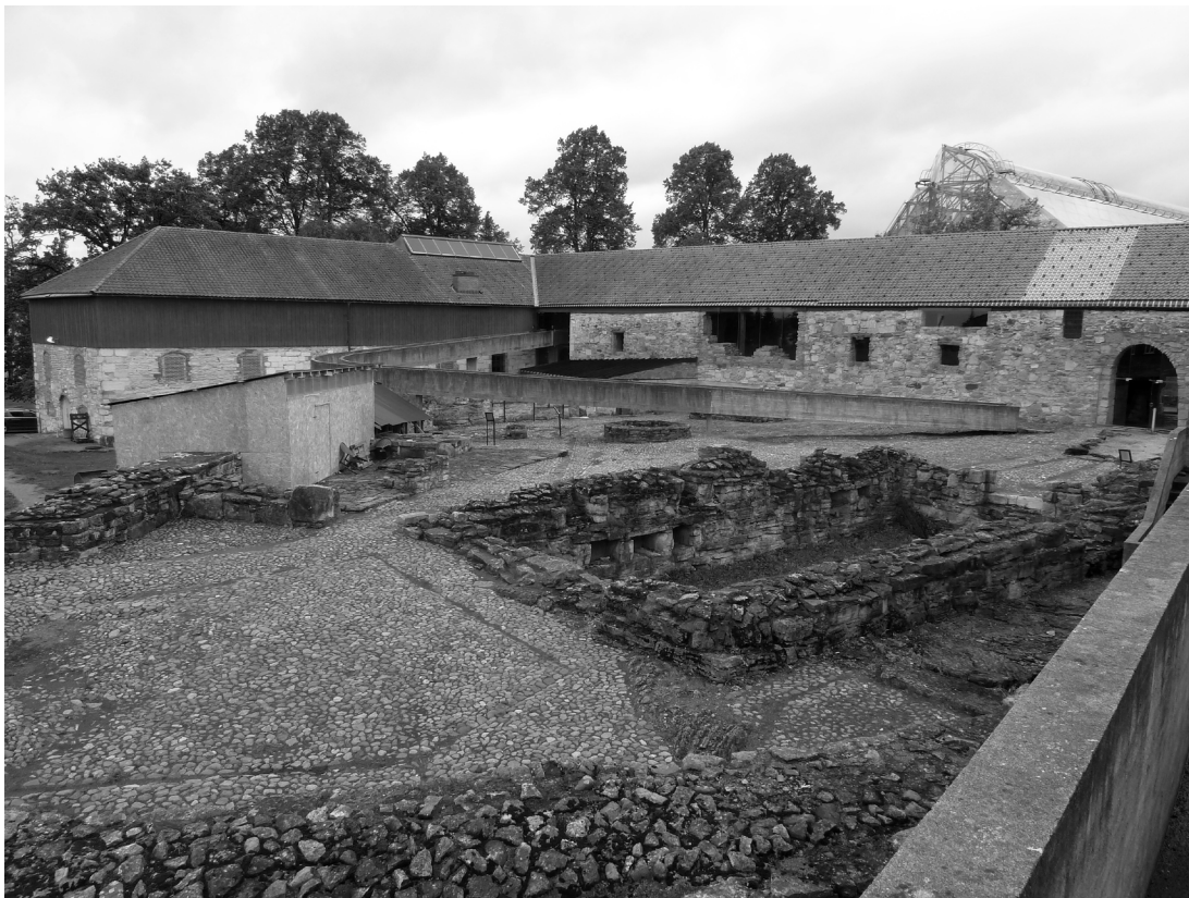
Fig.12: Patio del Museo Hedmark donde se observa el estado de las ruinas de la fortaleza del obispo y las casetas protectoras donde se están realizando los trabajos de restauración. Asimismo, se aprecia el color oscuro de la teja por la proliferación de algas –sobre todo en la orientación norte-. Primavera de 2016.
