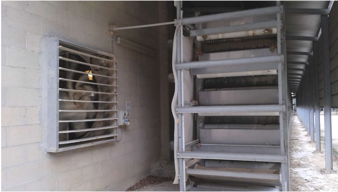
Figura 1.11: Túnel de secado de gallinaza exterior de una explotación avícola.
